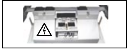
Rys.: Skrzynka zaciskowa Zagrożenie spowodowane napięciem elektrycznym
