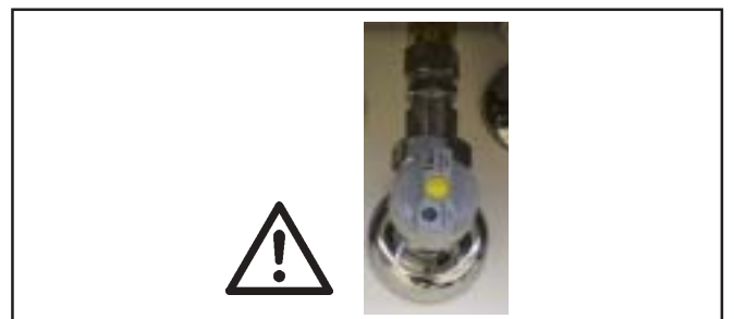
Bild: Gasanschluß Gefahr von Vergiftung und Explosion durch ausströmendes Gas
